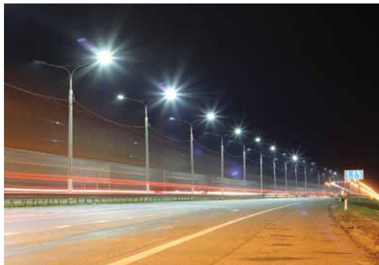
Светодиодные светильники на Федеральной трассе М-4 «Дон»
